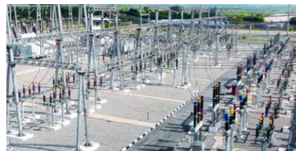
合作区 330KV 变电站
